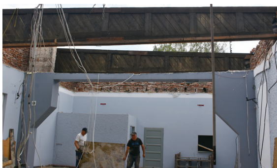
Roboty w trakcie remontu dachu na budynku CKiS w Zdzieszulicach Dolnych (sierpień 2019)
